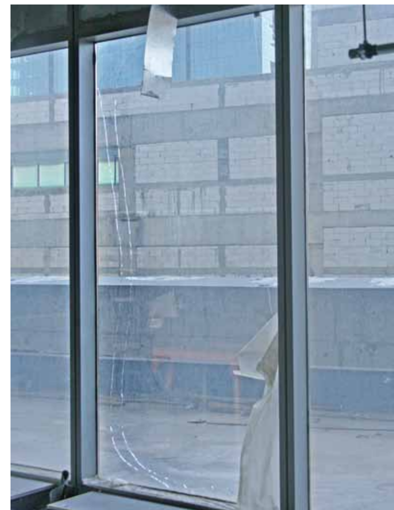
Рис.4.7.16. Трещина в стеклопакете, вызванная осадками здания
