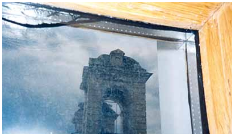
Рис.3.1.4. Разрушение бутилового герметика под действием УФ в первом контуре герметизации при нарушении технологии нане- сения (попада- ние во внутрен- нюю камеру стеклопакета)
