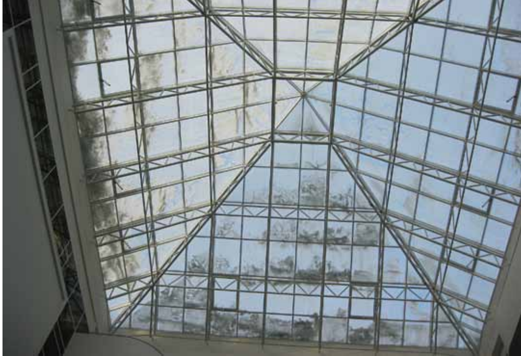
Рис. 4.5.1. Частичное обледенение и снег на светопрозрачной кровле атриумного корпуса МГСУ
