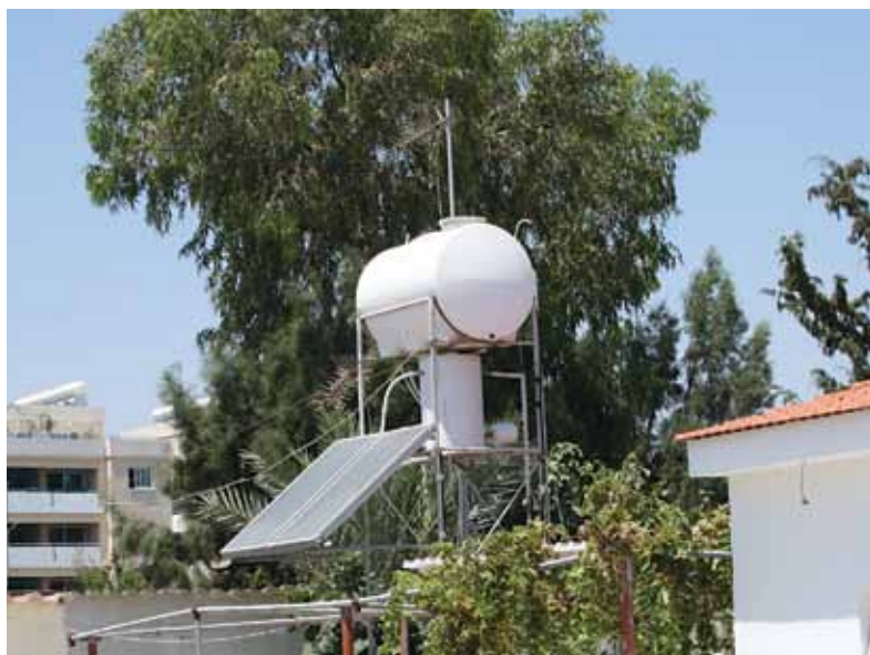
Рис.5.4. Коллектор горячей воды на крыше жилого дома, обогреваемый прямым солнечным теплом и дополнительными солнечными батареями. О. Кипр.
