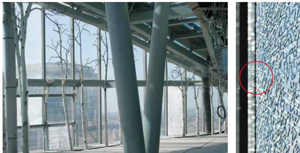
а) Рис. 4.7.6. Разрушение закалённых стёкол в стеклопакетах башни Федерация комплекса Москва-Сити. а) общий вид атриума с разрушенными стёклами; б) образование фокуса излома в краевой зоне стеклопакета
