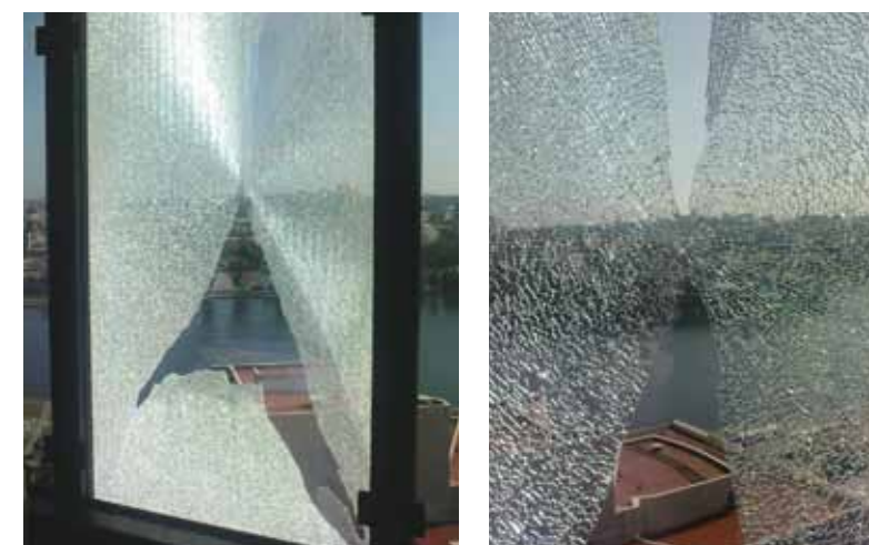
Рис. 4.7.8. Разрушение закалённого стекла в стеклопакетах отеля Хайат, г. Екатеринбург
