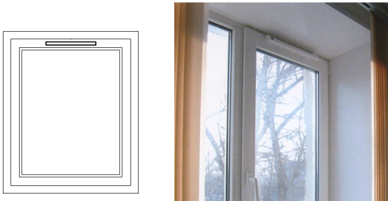
Рис.5. Вентиляционное приточное устройство в составе окна.
